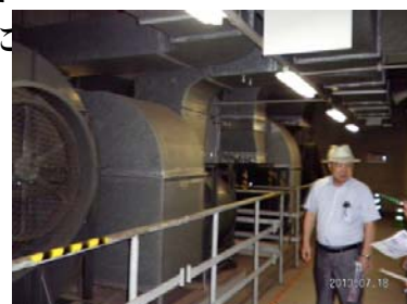
コ・ジェネレーションシステム
